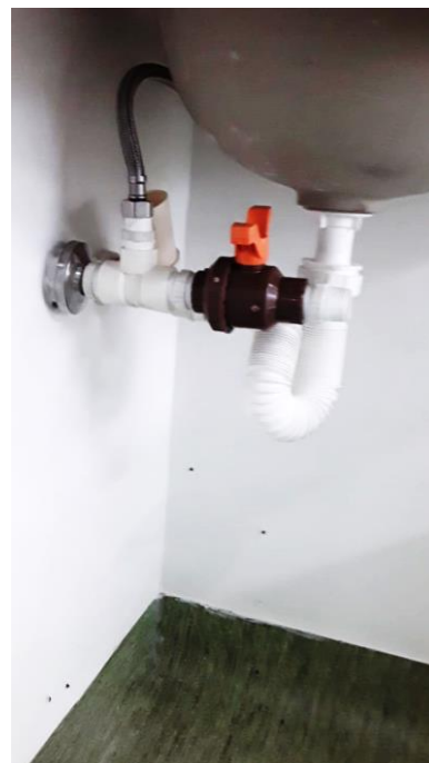
Ampliação dos pontos de hemodiálise
