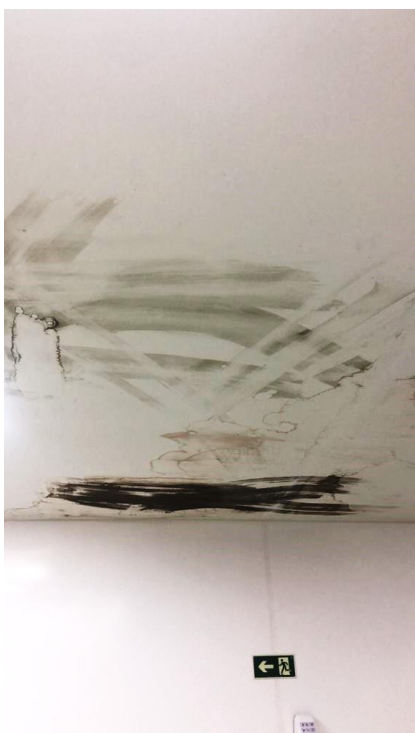
Antes – Teto Bloco Cirúrgico
