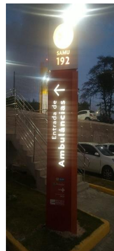
Instalação elétrica do letreiro do SAMU
